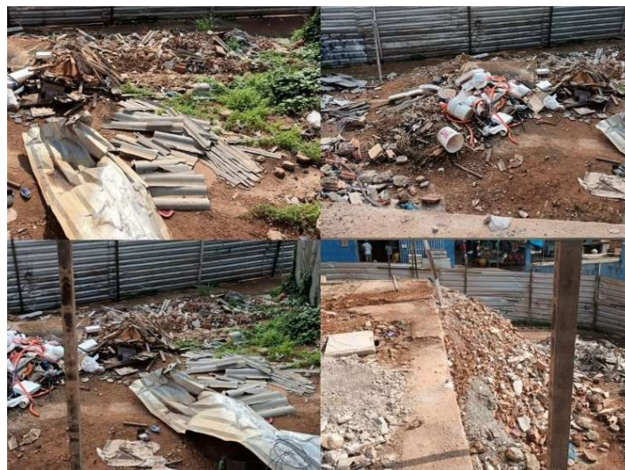
Figura 3 – Resíduos gerados na Obra B. Fonte: Autor do Trabalho.
