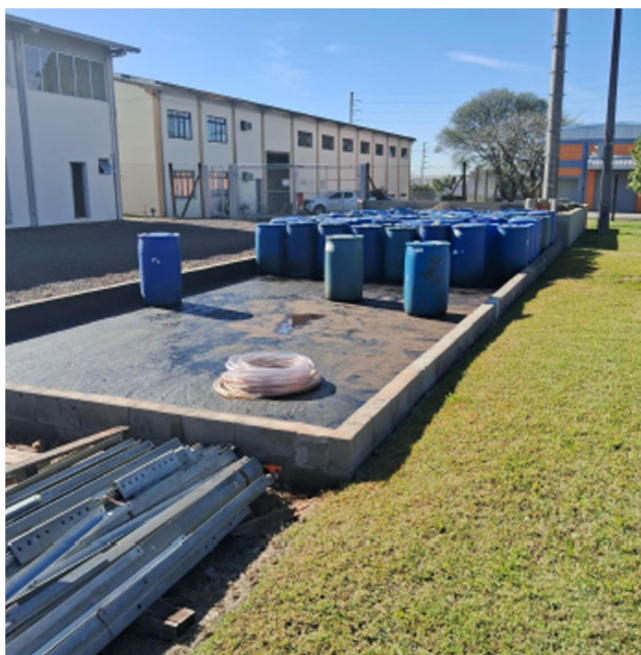
Figura 1: Armazenamento de óleo na subestação. Fonte: Copel, 2025.
