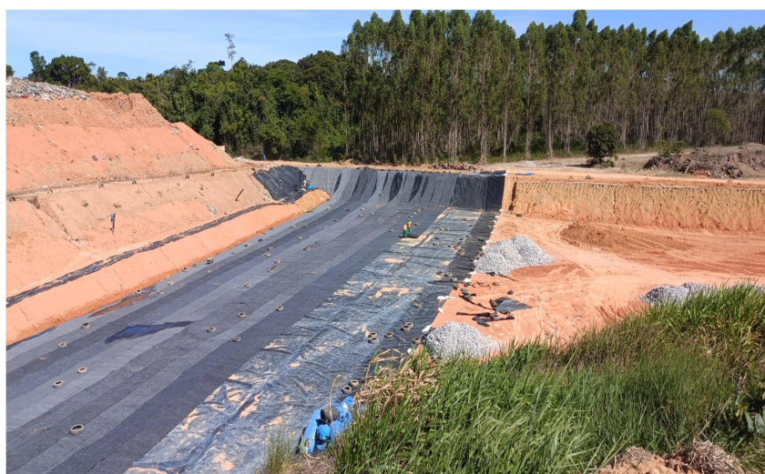
Figura 8: Futuro local de aterramento.
