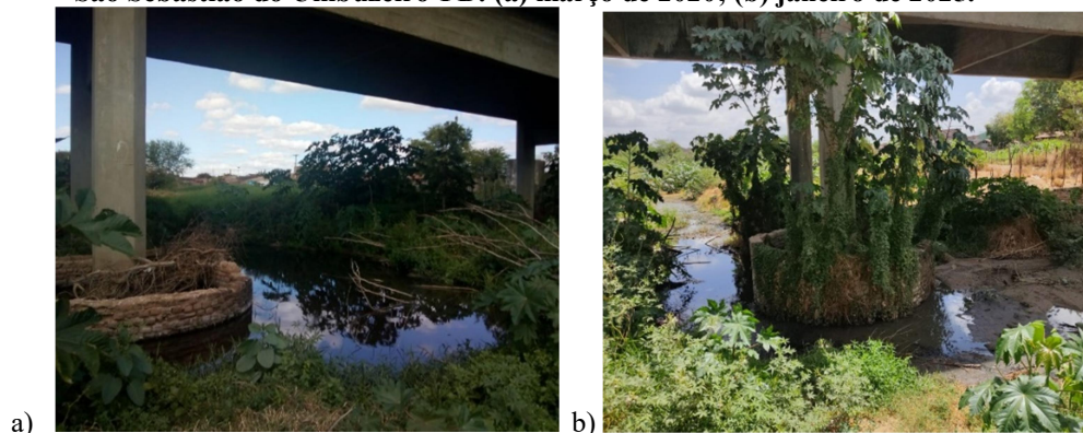
Figura 2: Acúmulo de esgoto residual alusivo ao aglomerado urbano à direita do rio Umbuzeiro, município de São Sebastião do Umbuzeiro-PB: (a) março de 2020; (b) janeiro de 2025.
