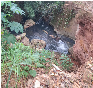
Erosão e assoreamento
