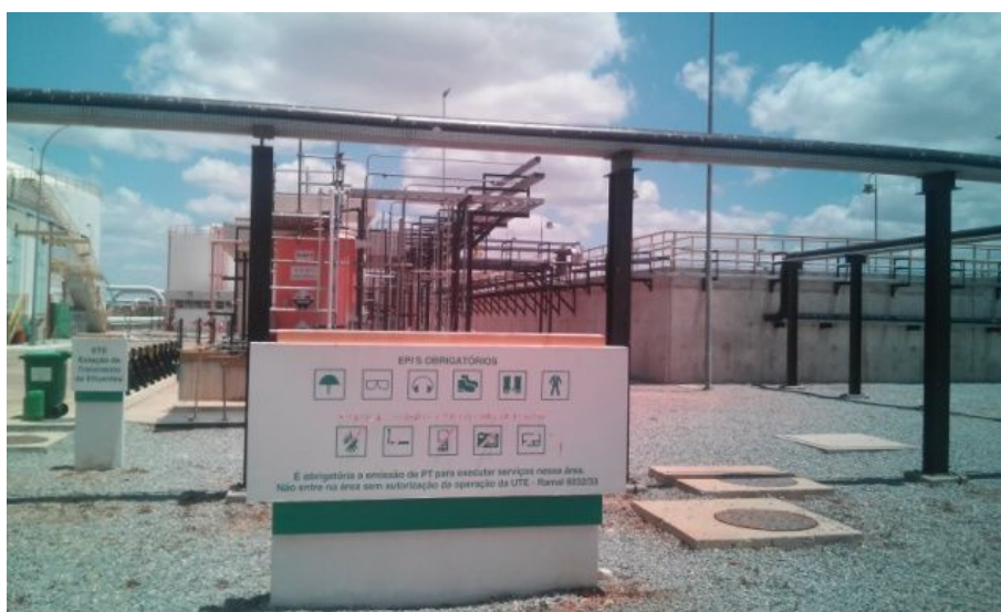
Figura 5: Sinalizações de segurança disponibilizados em variados locais da Usina Termelétrica Jesus Soares Pereira – UTE JSP/Termoçu. Fonte: Autor do Trabalho.
