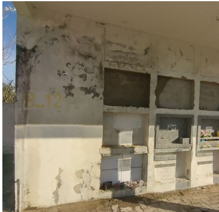
Figura 3: Infiltração na parte superior das gavetas. Fonte: Autora do trabalho.
