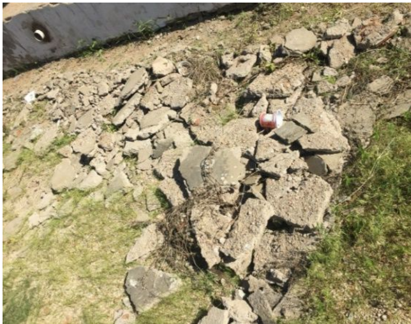
Figura 1. Material encontrado na obra. Fonte: Autor do trabalho.
