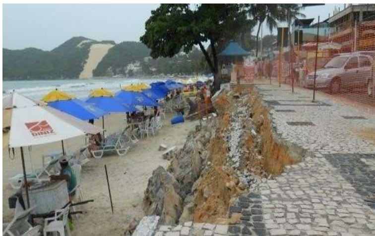
Figura 02 – Calçadão da Orla de Ponta Negra parcialmente destruído por ressaca, 2012. Fonte: Uol Notícias.
