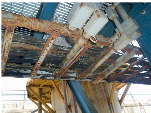
Figura 4: Canaleta de suporte da fiação danificada pela corrosão na área da centrífuga. Fonte: ACP nº 5208124-27.2019.8.13.0024 (TJMG).
