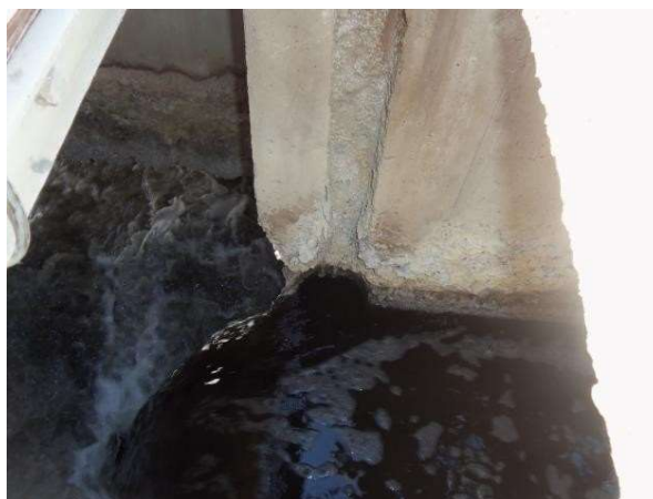
Figura 2: Corrosão do concreto em parte interna do reator anaeróbio. Fonte: ACP n° 5208124-27.2019.8.13.0024 (TJMG).
