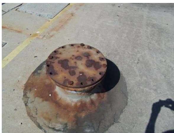
Figura 5: Tubulação de aço carbono obstruída, devido à reação do material do tubo com o gás gerado na ETE. Fonte: ACP nº 5208124-27.2019.8.13.0024 (TJMG).
