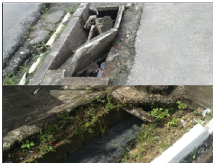
Figura 6 - Canaletas danificadas. Fonte: Autores, 2023.
