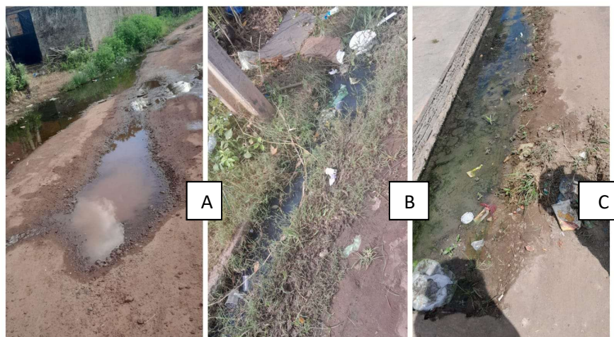
Figura 3: Esgoto a céu aberto nas ruas Treze de Maio (A); São Francisco (B) e São Raimundo (C). Fonte: Rodrigues et al., 2023.
