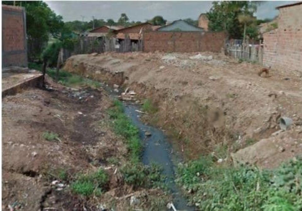
Figura 1: Trecho do canal antes do início da obra. Fonte: Autor do Trabalho.
