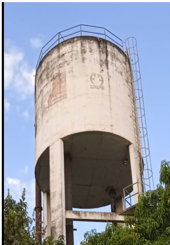
Figura 1 - Caixa d'água responsável por abastecer o bairro Getat. Fonte: Elaborado pelos autores, (2022)
