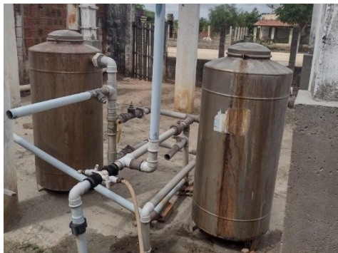
Figura 8: Filtros centrais utilizados no tratamento simples. Fonte: Autor do trabalho.
