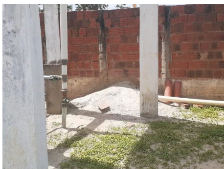
Figura 9: Depósito de areia retirado do reservatório. Fonte: Autor do trabalho.
