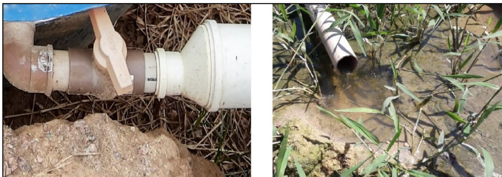
Figura 2 - Sistema hidráulico do SACV A - Registro manual para regulagem da vazão; B – Entrada do efluente no SACV.
