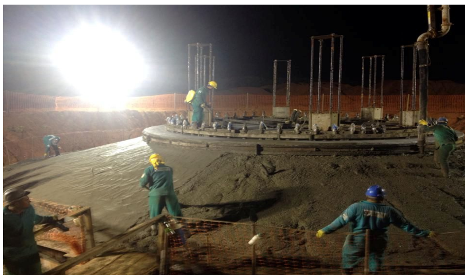
Figura 8: Construção da Base para Instalação dos Aerogeradores - Parque Eólico Areia Branca/RN. Fonte: Allan Kardek.
