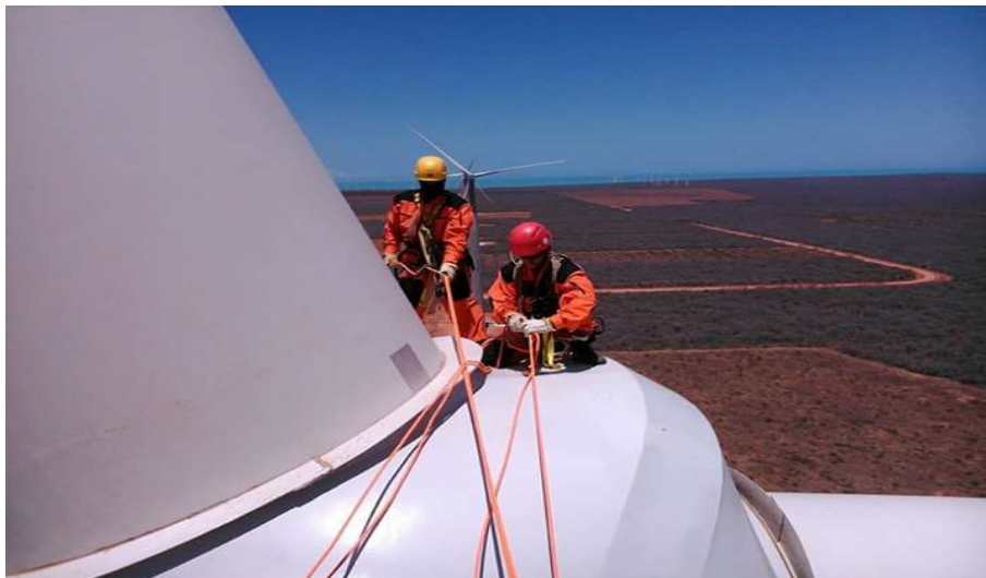
Figura 9: Instalação das hélices dos Aerogeradores – Parque Eólico Areia Branca/RN. Fonte: Tarcísio Anderson.
