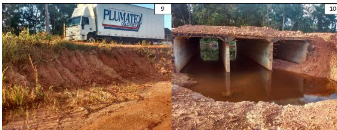
Figura 9. Erosão lateral da rodovia em áreas que foram preenchidas para nivelar a pista. Fonte: Autoras, 2019.
