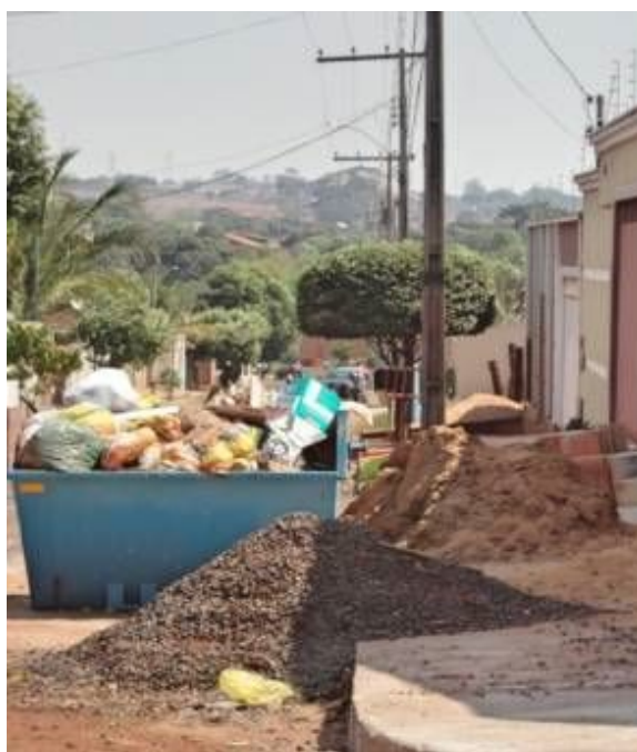
Figura 1 - Deposição de agregados de construção civil de modo incorreto. Fonte: Reis de Paula & Romio, 2014.
