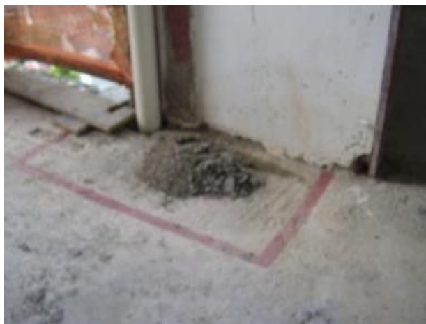
Figura 3 - Demarcação no piso para deposição de resíduos classe A. Fonte: Os autores (2019).
