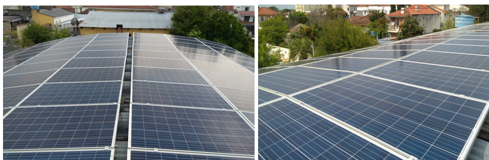
Figura 2: Painéis fotovoltaicos instalados no telhado do estabelecimento, São Gabriel – RS. Fonte: acervo ABIB, 2017.
