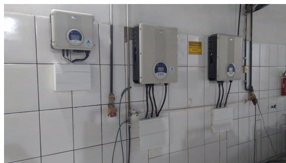
Figura 3: Inversores que compõem a parte interna do sistema fotovoltaico do estabelecimento comercial, São Gabriel – RS, 2018. Fonte: Autores, 2018.
