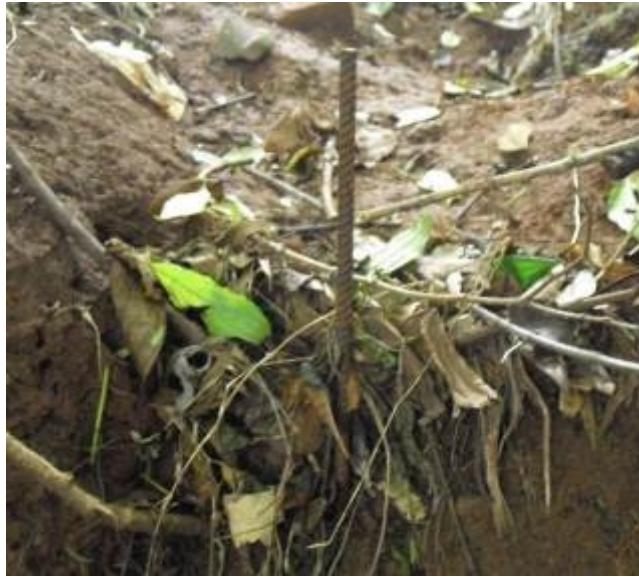
Figura 5 – Erosão na jusante da estaca causada pelo acúmulo de resíduos a montante.
