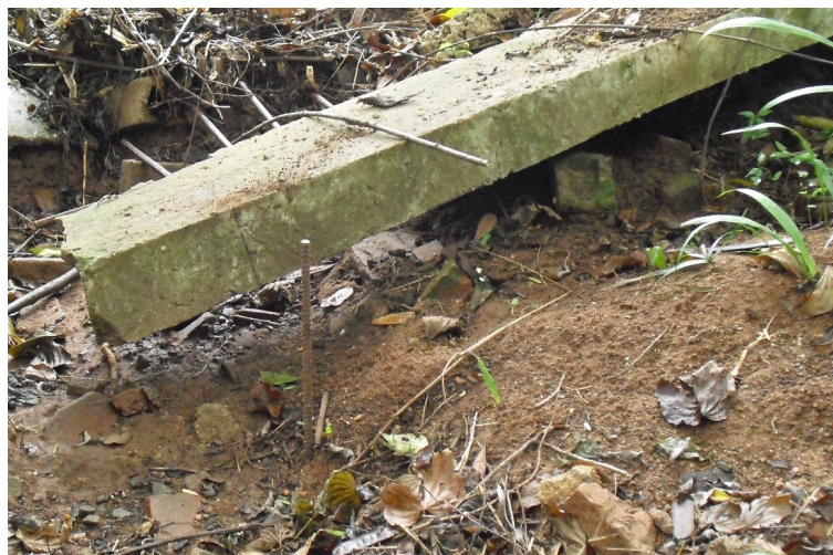
Figura 6 – Acúmulo de sedimentos à direita, entre E-03 e E-02.
