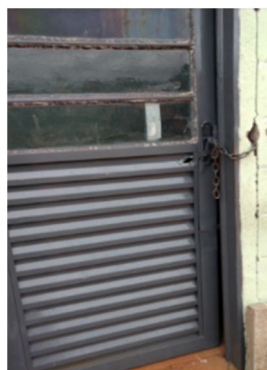
Figura 3: Porta danificada em edificação de um ecoponto. Fonte: Autores do Trabalho.
