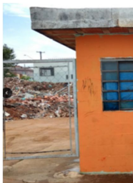
Figura 2: Buraco em portão de ecoponto. Fonte: Autores do Trabalho.
