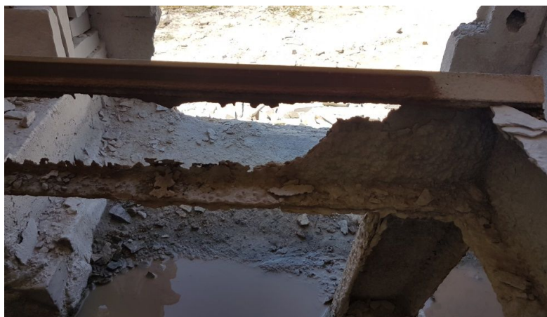
Figura 2: – Corrosão do maquinário pela lama do processo. Fonte: Autor do trabalho.
