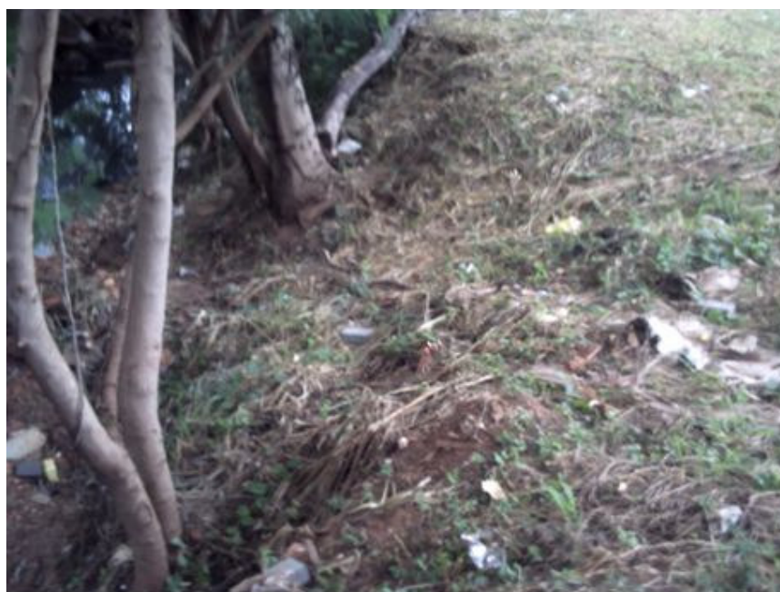
Figura 6. Erosão encontrada perto da plataforma de travessia de pedestres no ponto 03.
