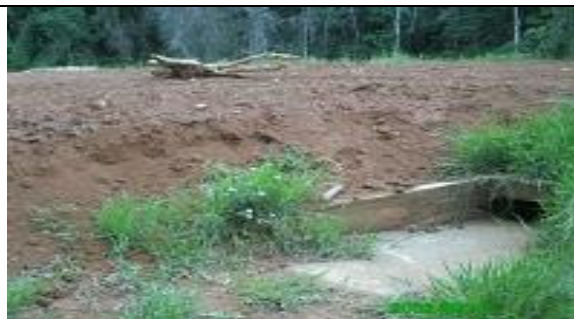
FIGURA 2 - Talude com solo sem cobertura vegetal. ( Setembro - 2009)
